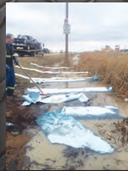
Diesel spill pad use
